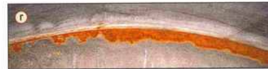
Отслоение плакирующего слоя
