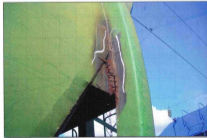
Рис. 2. Трещина в узле соединения стойки боковой стены с горизонтальной балкой торцевой стены
